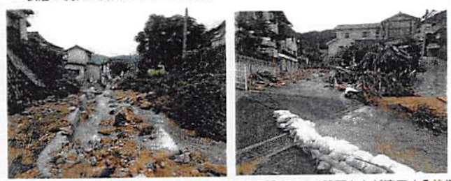
流路の埋塞状況 流路の閉塞により路面を水が流下する状況
