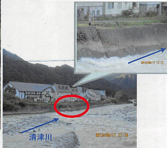
平成25年9月 台風18号による増水に伴う土砂移動で護岸が被災
