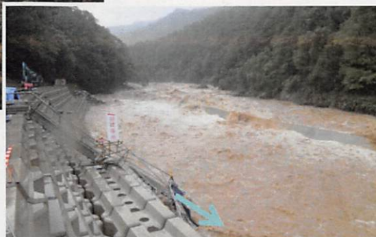
平成25年9月 台風18号での増水状況 (中津川上流溪流保全工)
