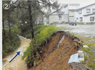
H23.8 台風12号豪雨による増水水状況
