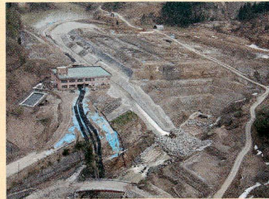
仮排水路による排水 (H16.12.18撮影)
